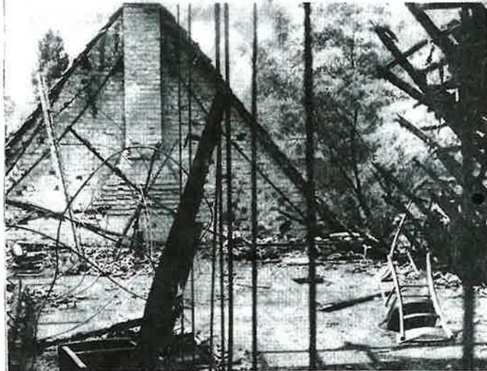
VÖLLIG AUSGEBRANNT ist der Dachstuhl der neuapostolischen Kirche in der Humboldtstraße in der Nacht von Freitag auf Samstag. Löschzüge aus Porz und Deutz hatten die Flammen schnell unter Kontrolle, ein hoher Sachschaden konnte jedoch nicht verhindert werden. Bildart: LÖBBER
