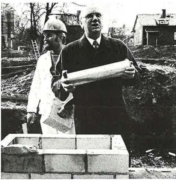
Apostel Heinz Freudenberg aus Lahnstein (rechts) zeigte den Gläubigen die Kupferrolle, ehe er sie endgültig in das dafür vorbereitete Mauerwerk versenkte. Aufgabe des Poliers Franz Seifer aus Biersdorf war es, die Rolle fachgerecht einzumauern. In ein- und einhalbjähriger Bauzeit wird sich hier gegenüber der Siegerlandhalle der Neubau der Neuapostolischen Kirche erheben.
