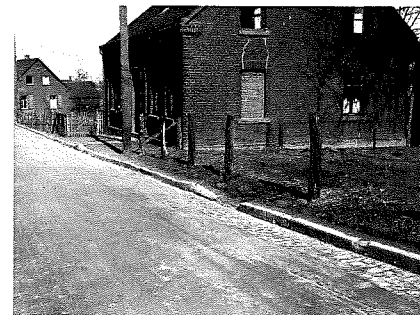
Typisches Bergmannshaus, das durch Bergschäden abbruchreif geworden ist.
