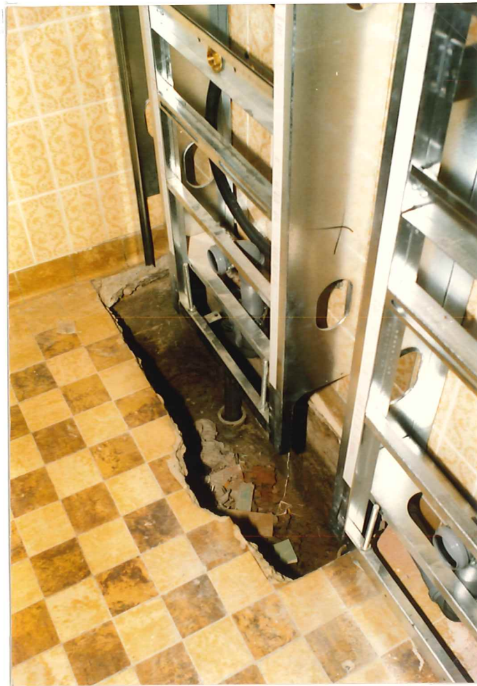
Grundkanal im Herren-WC
