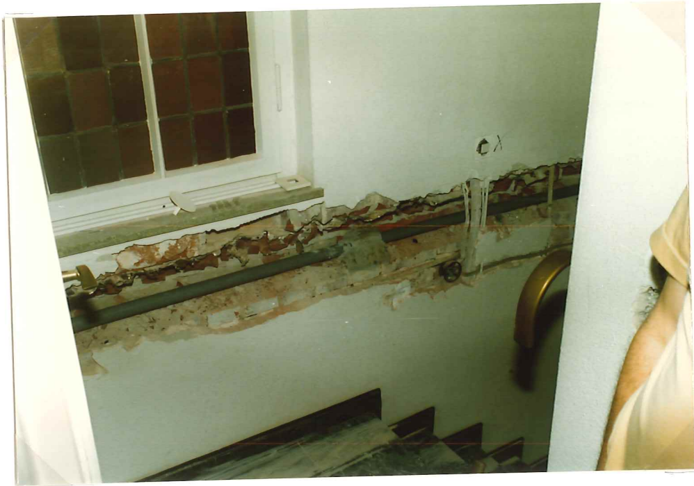
Leitungsführung im Treppenaufgang zu den neuen Übersetzerkabinen
