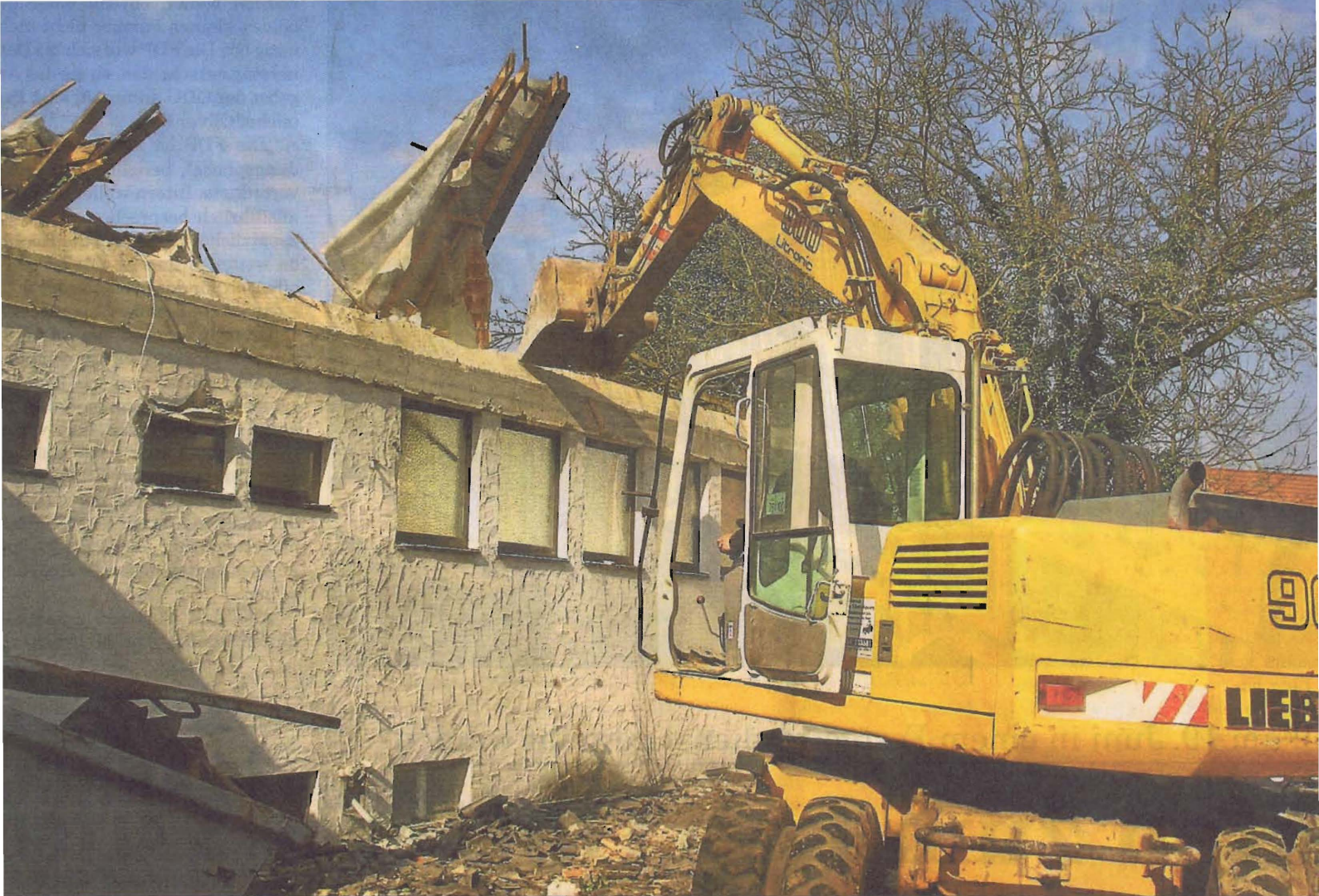
Der Bagger greift zu: Nun fallen die Mauern des einstigen Gronauer Treffpunktes der Neupostolischen Gemeinde.
